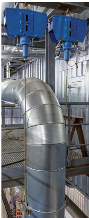
石炭焚発電所での コンスタントハンガー
