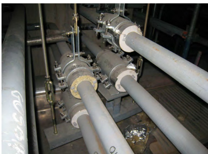
極低温用サポートで支持された配管
