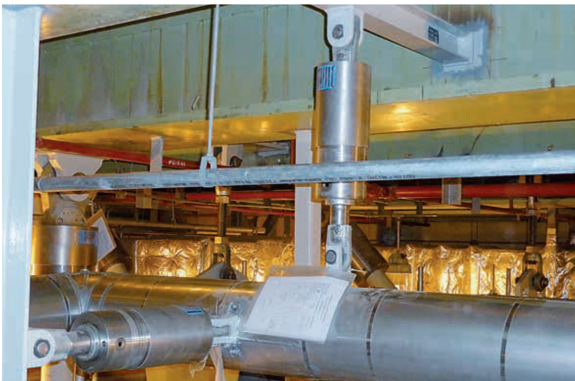
Трубопровод защищен ударными стопорами типа 30, присоединенными к хомутам типа 36
