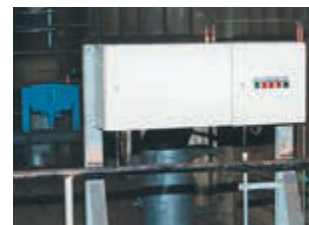
Шкаф управления сервоподвесок
