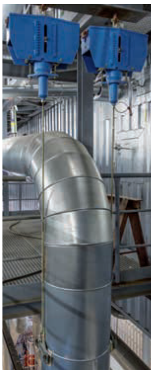
Подвеска постоянного усилия на угольной электростанции
