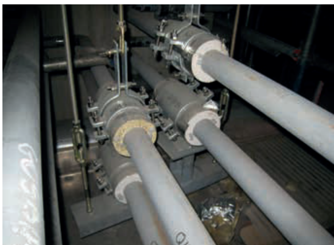
Трубы, поддерживаемые в нужном положении с помощью низкотемпературных изолированных опор
