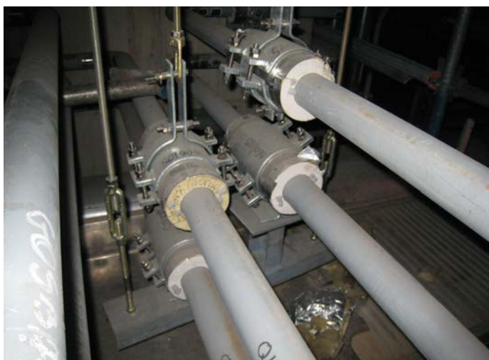
Tuberías sujetas en posición mediante soportes criogénicos
