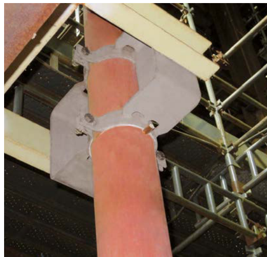
Soporte de tubería (tipo 49 ... G2P)
