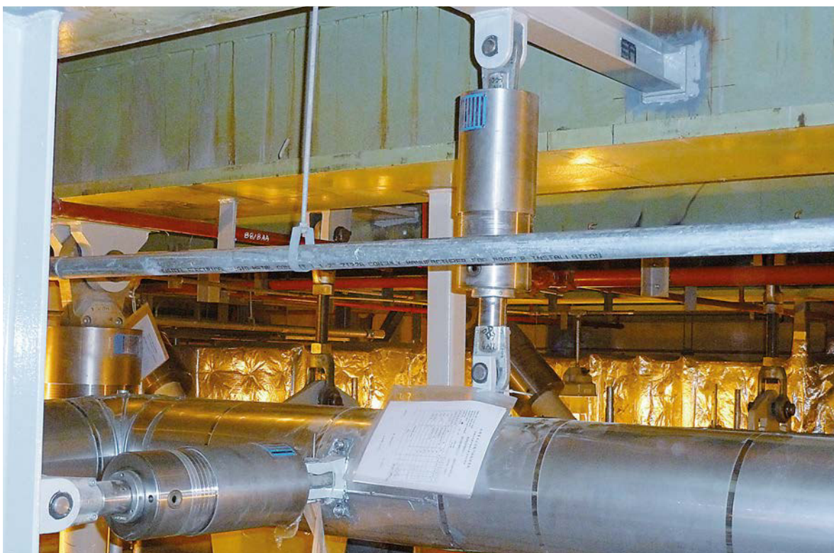
Sistema de tuberías fijado con un amortiguador hidráulico tipo 30 sobre abrazaderas dinámicas tipo 36
