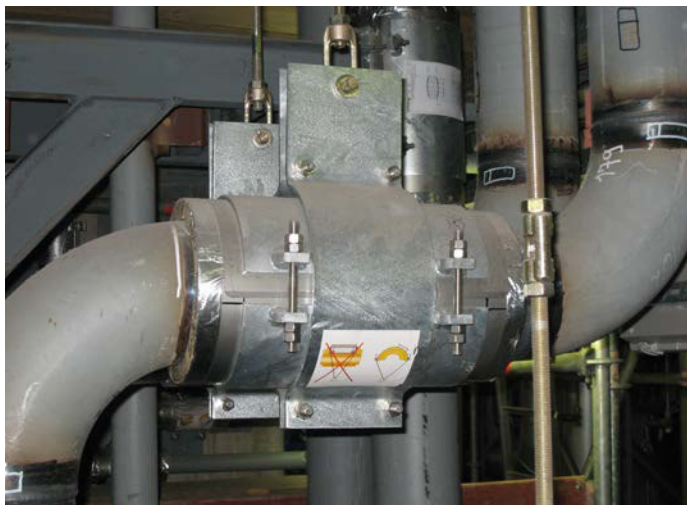
Suspensión con abrazaderas para tuberías criogénicas
