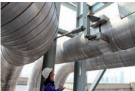
Kontrolle von Halterungen in der Anlage
