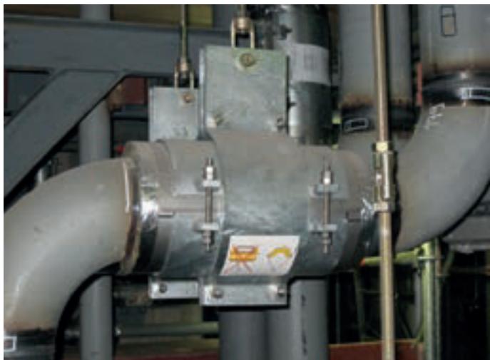
Abhängung mit kryogenen Rohrschellen
