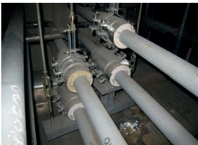
Halterung von Rohren mit kälteisolierten Unterstüzungen
