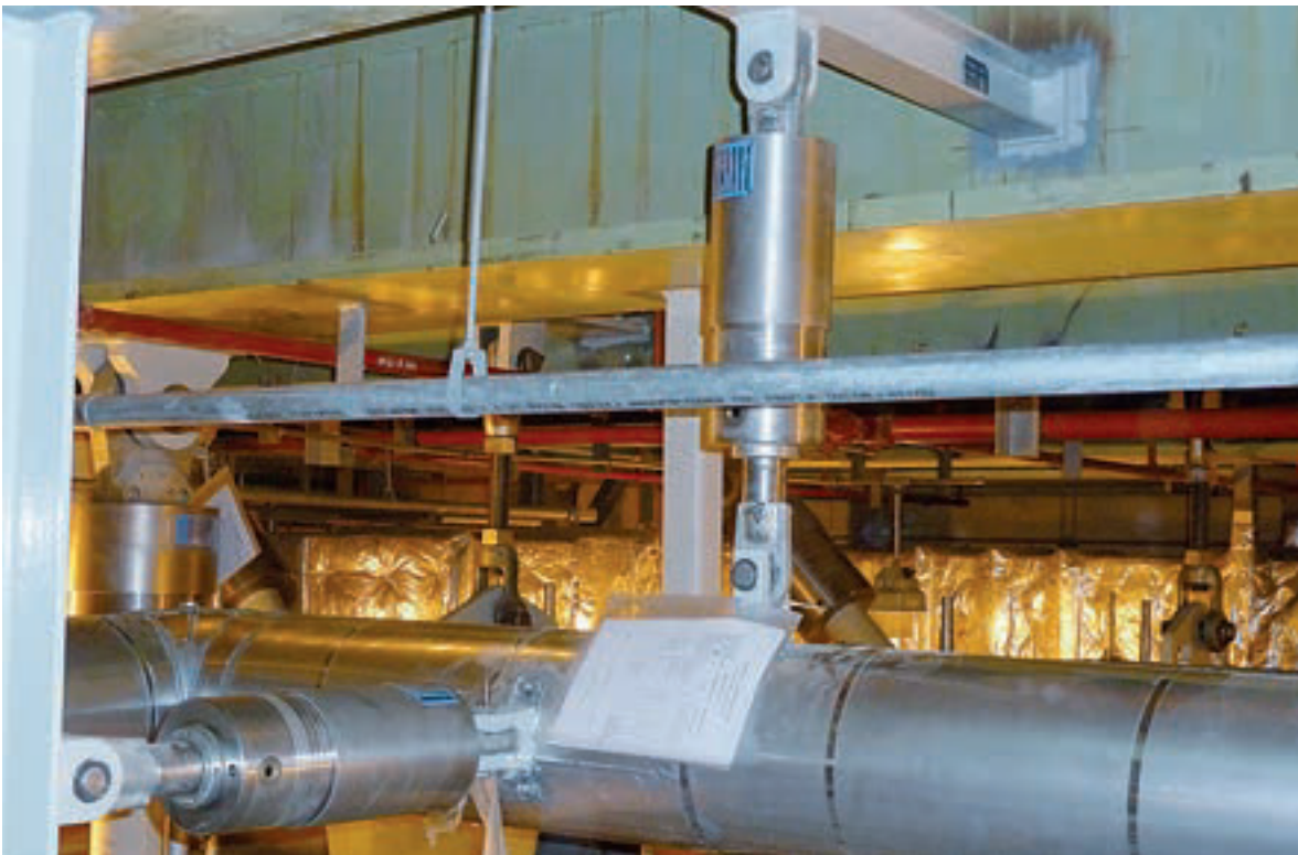
Sicherung der Rohrleitung mit Stoßbremsen Typ 30 an Wechsellastschellen Typ 36
