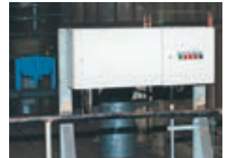
Schaltschrank eines Servohängers
