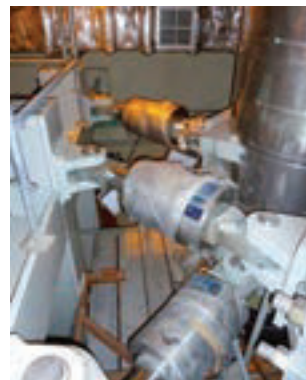
Sécurisation de tuyauterie grâce à des DAB Type 30
