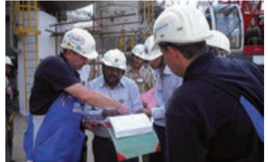
Discussion sur les résultats et les observations après contrôle d'un réseau de tuyauteries
