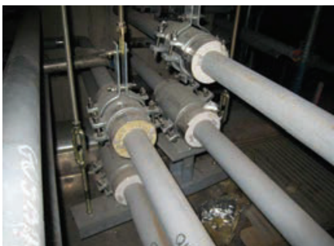
Supportage de tuyauterie avec appuis cryogéniques
