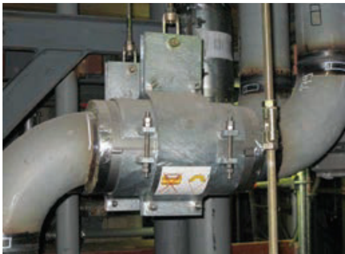
Supportage avec colliers cryogéniques
