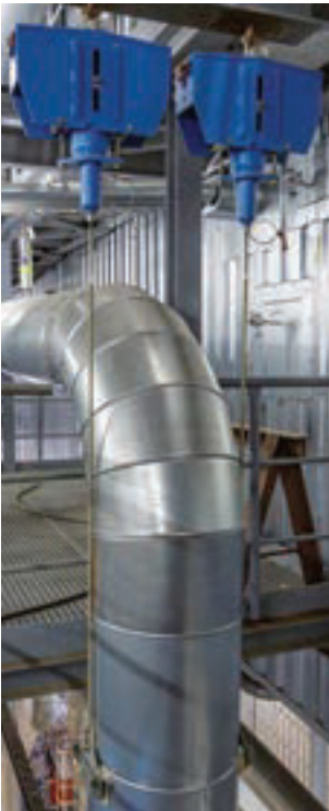
Support Constant installé dans une Centrale thermique
