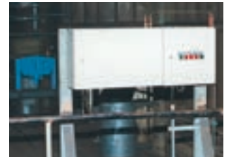
Schaltschrank eines Servohängers
