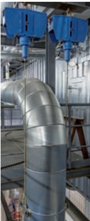
Konstanthänger in einem Kohlekraftwerk
