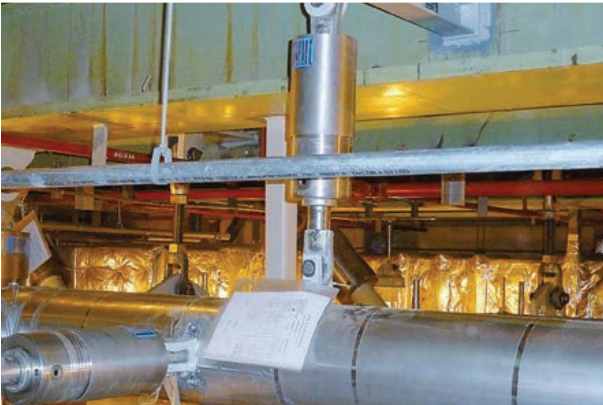
Sécurisation de la tuyauterie par des DAB Type 30 et des colliers dynamiques Type 36
