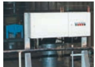
Schaltschrank eines Servohängers
