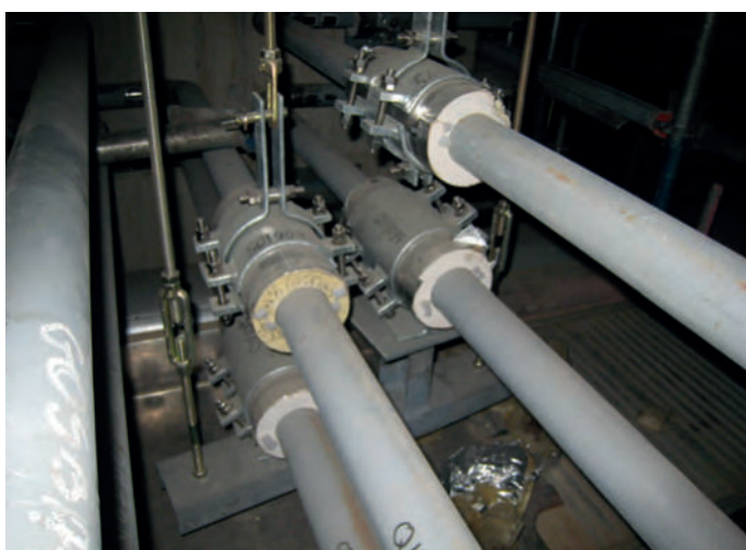
Supportage de tuyauterie avec appuis cryogéniques
