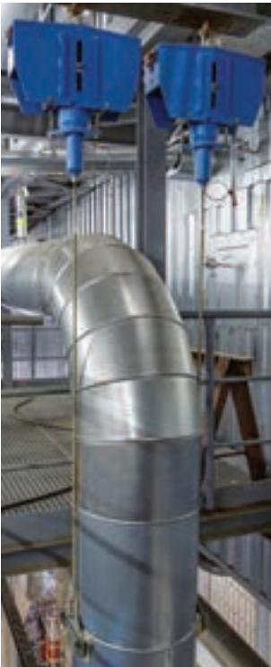
Support Constant installé dans une Centrale thermique
