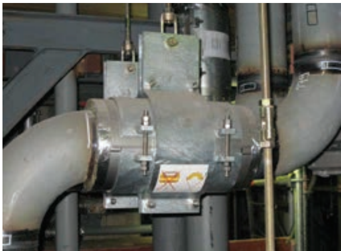
Supportage avec colliers cryogéniques
