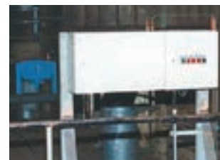
Armoire de commande d'un support constant assisté
