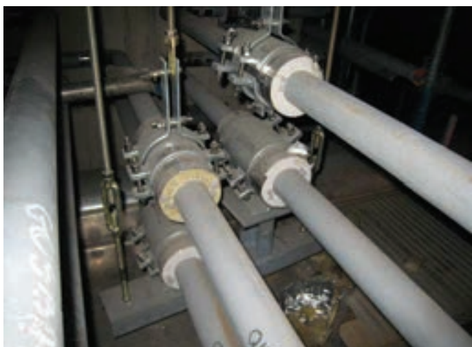
Supportage de tuyauterie avec appuis cryogéniques
