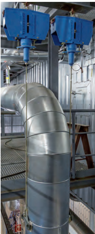
Konstanthänger in einem Kohlekraftwerk
