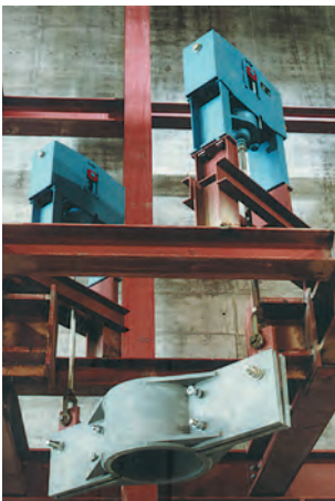
Unterstützung eines Verticalstranges mit Sonderkonstruktion vom Typ 45
